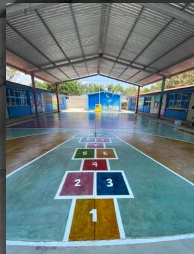
SOBRE PISO OXIDADO
